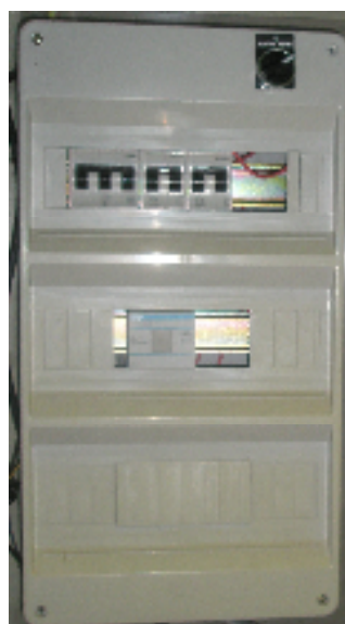
Fig. 36 Particolare quadro elettrico generale I.P. a Folgaria Fondo Grande (QFG1)
