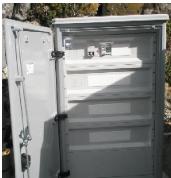
Fig. 9 Quadro elettrico generale I.P. a Folgaria Molini (QMO1)
