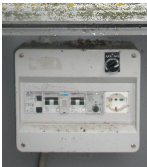
Fig. 52 Particolare quadro elettrico generale I.P. a Folgaria Girardi di Sopra (QGS1)
