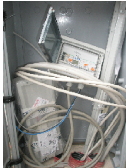
Fig. 58 Particolare quadro elettrico generale I.P. a Folgaria Tezzele (QTE1)
