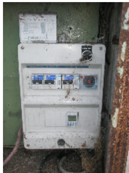
Fig. 26 Particolare quadro elettrico generale I.P. a Folgaria Carpaneda (QCA1)
