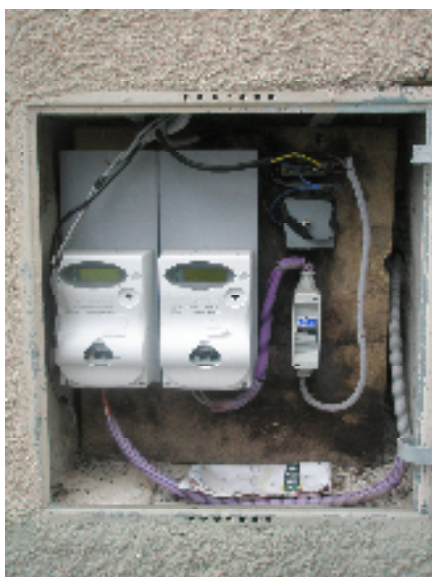
Fig. 53 Quadro elettrico generale I.P. a Folgaria Perempruneri (QPR1)
