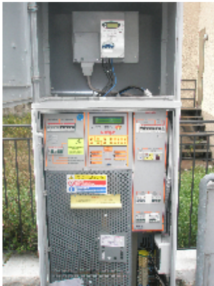
Fig. 45 Quadro elettrico generale I.P. a Folgaria Carbonare (QCB1)
