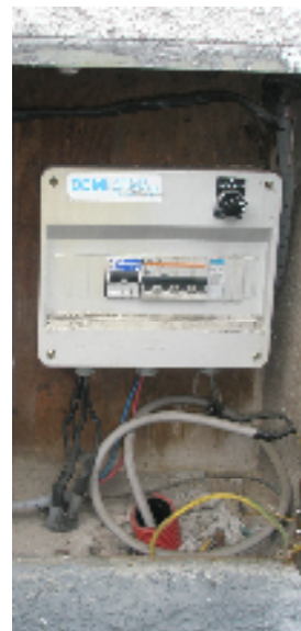
Fig. 60 Particolare quadro elettrico generale I.P. a Folgaria Virti (QVI1)
