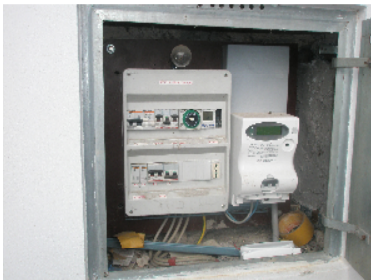
Fig. 41 Quadro elettrico generale I.P. a Folgaria Nocchi (QNC1)
