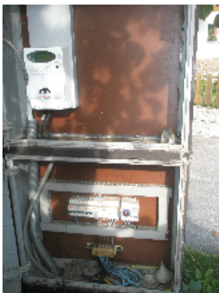
Fig. 33 Quadro elettrico generale I.P. a Folgaria Espameri (QES1)
