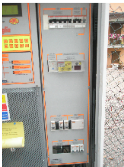
Fig. 56 Particolare quadro elettrico generale I.P. a Folgaria S. Sebastiano (QSS1)
