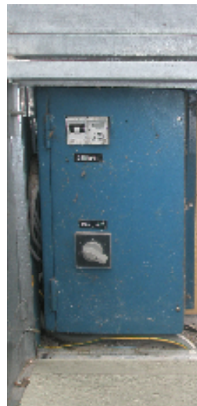
Fig. 48 Particolare quadro elettrico generale I.P. a Folgaria Cueli-Liberi (QCU1)
