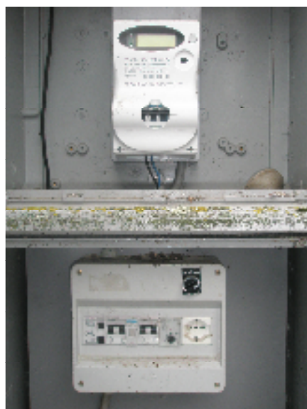
Fig. 51 Quadro elettrico generale I.P. a Folgaria Girardi di Sopra (QGS1)
