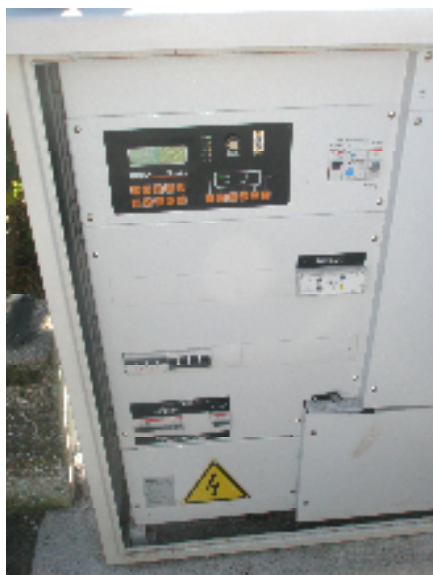
Fig. 75 Quadro elettrico generale I.P. a Folgaria via Cadorna (QFL8)
