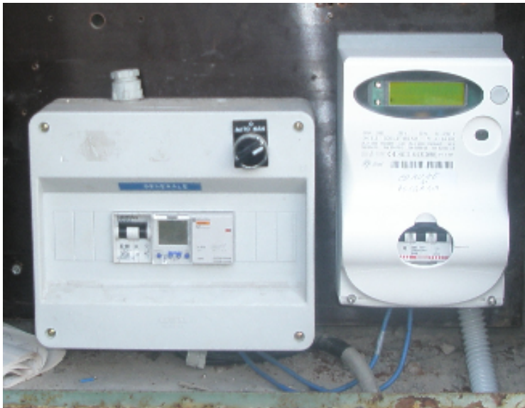
Fig. 37 Quadro elettrico generale I.P. a Folgaria Francolini (QFR1)
