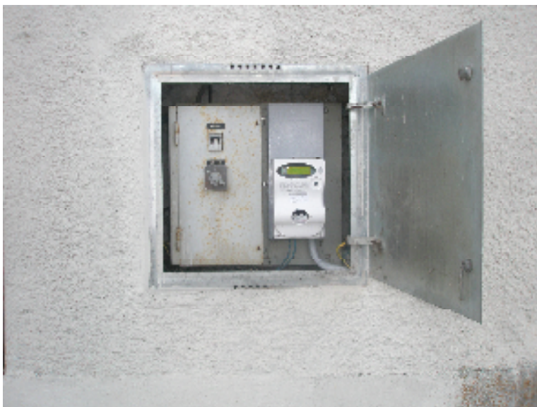
Fig. 39 Quadro elettrico generale I.P. a Folgaria Mezzaselva (QMS1)
