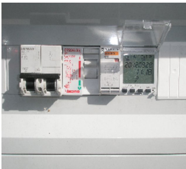
Fig. 10 Particolare quadro elettrico generale I.P. a Folgaria Molini (QMO1)
