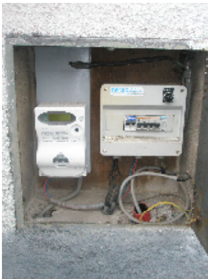
Fig. 59 Quadro elettrico generale I.P. a Folgaria Virti (QVI1)
