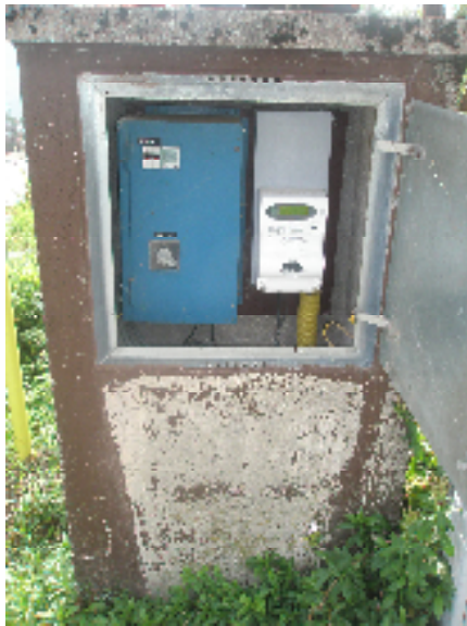
Fig. 61 Quadro elettrico generale I.P. a Folgaria Pra di Sopra (QPS1)
