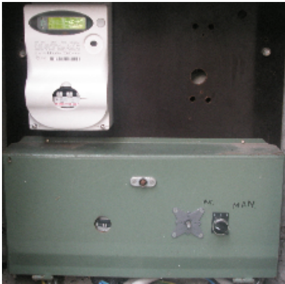
Fig. 5 Quadro elettrico generale I.P. a Folgaria Mezzomonte di Sotto (QMS1)
