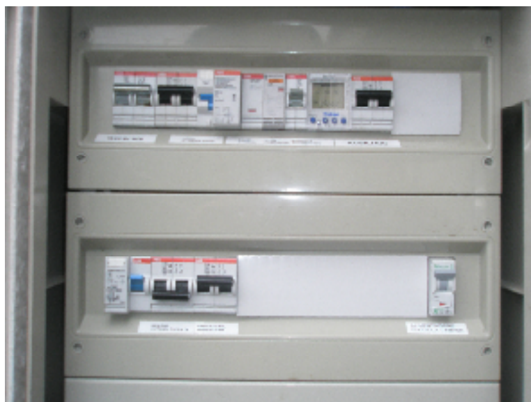
Fig. 50 Particolare quadro elettrico generale I.P. a Folgaria piazzale V.V.F. (QFL1)
