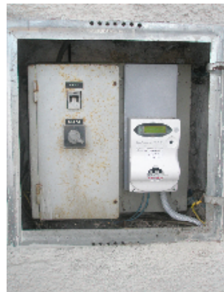
Fig. 40 Particolare quadro elettrico generale I.P. a Folgaria Mezzaselva (QMS1)
