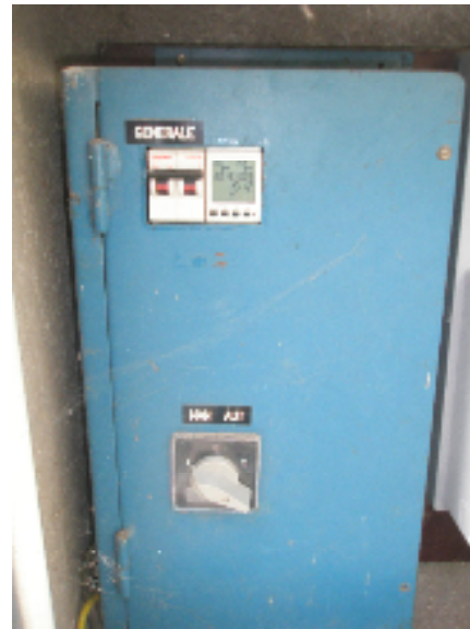
Fig. 62 Particolare quadro elettrico generale I.P. a Folgaria Pra di Sopra (QPS1)
