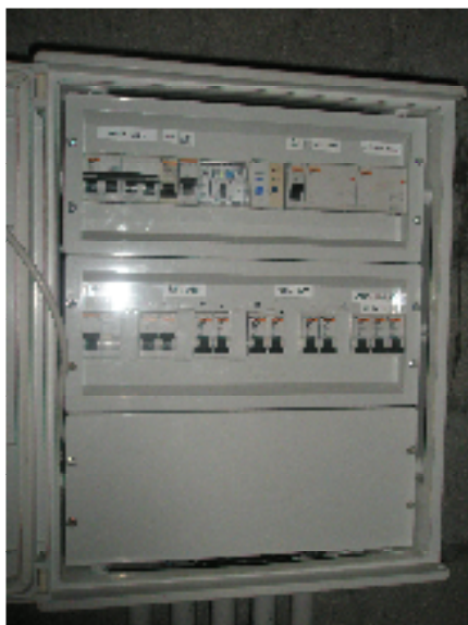
Fig. 43 Quadro elettrico generale I.P. a Folgaria Nosellari (QNO1)
