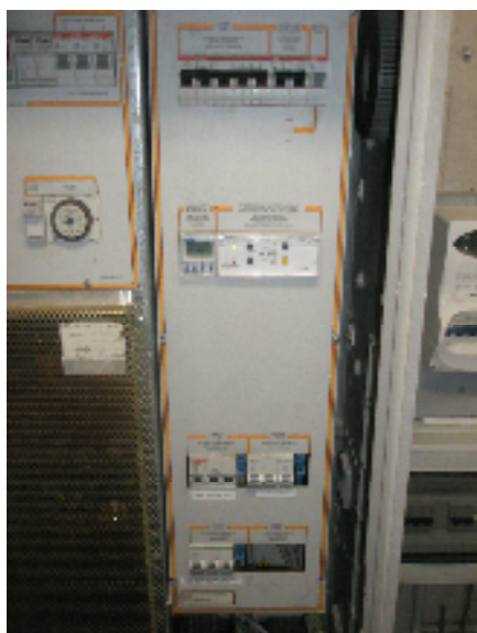
Fig. 71 Quadro elettrico generale I.P. a Folgaria Palaghiaccio (QFL6)
