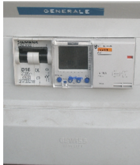
Fig. 38 Particolare quadro elettrico generale I.P. a Folgaria Francolini (QFR1)
