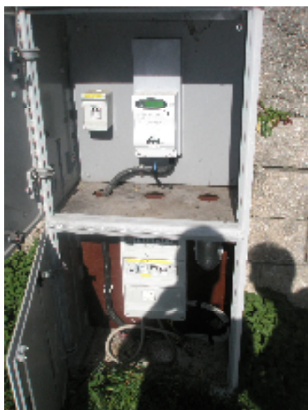
Fig. 73 Quadro elettrico generale I.P. a Folgaria via Degasperi (QFL6)
