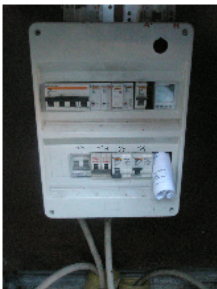
Fig. 69 Quadro elettrico generale I.P. a Folgaria via XXV Aprile (QFL5)
