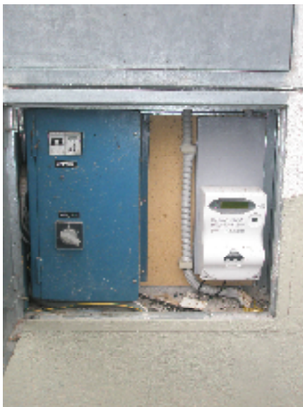
Fig. 47 Quadro elettrico generale I.P. a Folgaria Cueli-Liberi (QCU1)
