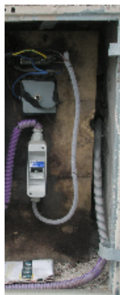
Fig. 54 Particolare quadro elettrico generale I.P. a Folgaria Perempruneri (QPR1)
