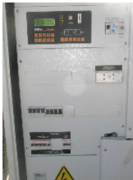
Fig. 76 Particolare quadro elettrico generale I.P. a Folgaria via Cadorna (QFL8)
