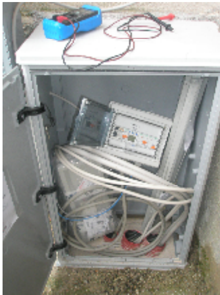
Fig. 57 Quadro elettrico generale I.P. a Folgaria Tezzele (QTE1)
