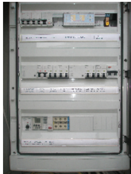
Fig. 8 Particolare quadro elettrico generale I.P. a Folgaria Mezzomonte di Sopra (QMS2)
