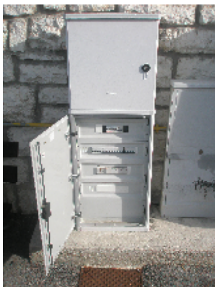
Fig. 65 Quadro elettrico generale I.P. a Folgaria C.R.I. (QFL3)
