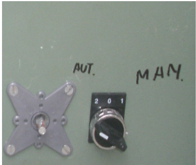
Fig. 6 Particolare quadro elettrico generale I.P. a Folgaria Mezzomonte di Sotto (QMS1)
