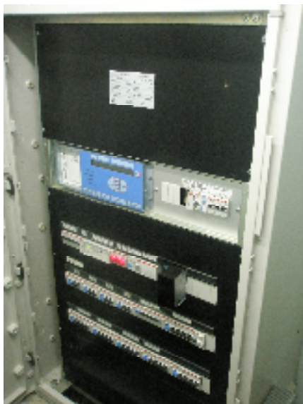
Fig. 63 Quadro elettrico generale I.P. a Folgaria rotatoria (QFL2)
