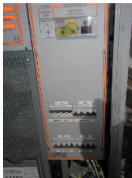
Fig. 68 Particolare quadro elettrico generale I.P. a Folgaria cabina (QFL4)
