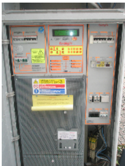
Fig. 55 Quadro elettrico generale I.P. a Folgaria S. Sebastiano (QSS1)
