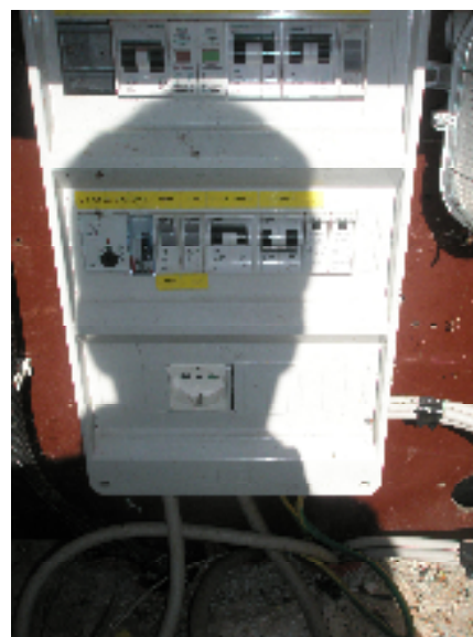
Fig. 74 Particolare quadro elettrico generale I.P. a Folgaria via Degasperi (QFL6)
