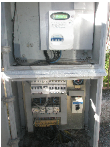
Fig. 77 Quadro elettrico generale I.P. a Folgaria via Trento (QFL9)
