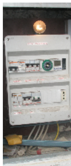
Fig. 42 Particolare quadro elettrico generale I.P. a Folgaria Nocchi (QNC1)
