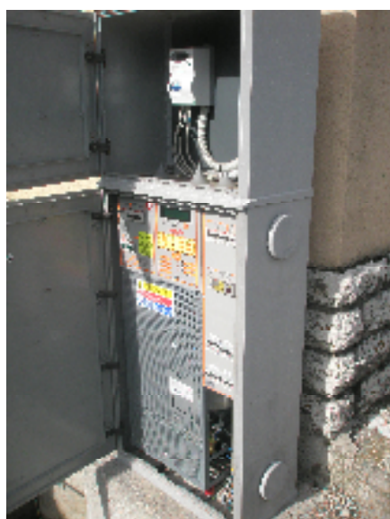
Fig. 67 Quadro elettrico generale I.P. a Folgaria cabina (QFL4)
