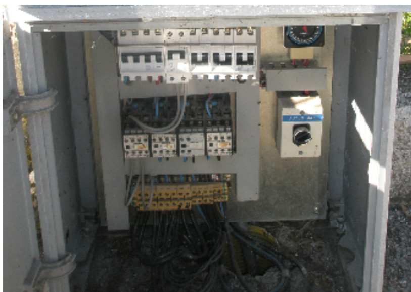
Fig. 78 Particolare quadro elettrico generale I.P. a Folgaria via Trento (QFL9)
