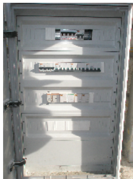
Fig. 66 Particolare quadro elettrico generale I.P. a Folgaria C.R.I. (QFL3)
