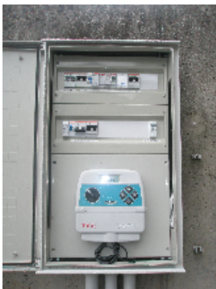
Fig. 49 Quadro elettrico generale I.P. a Folgaria piazzale V.V.F. (QFL1)
