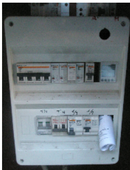
Fig. 70 Particolare quadro elettrico generale I.P. a Folgaria via XXV Aprile (QFL5)
