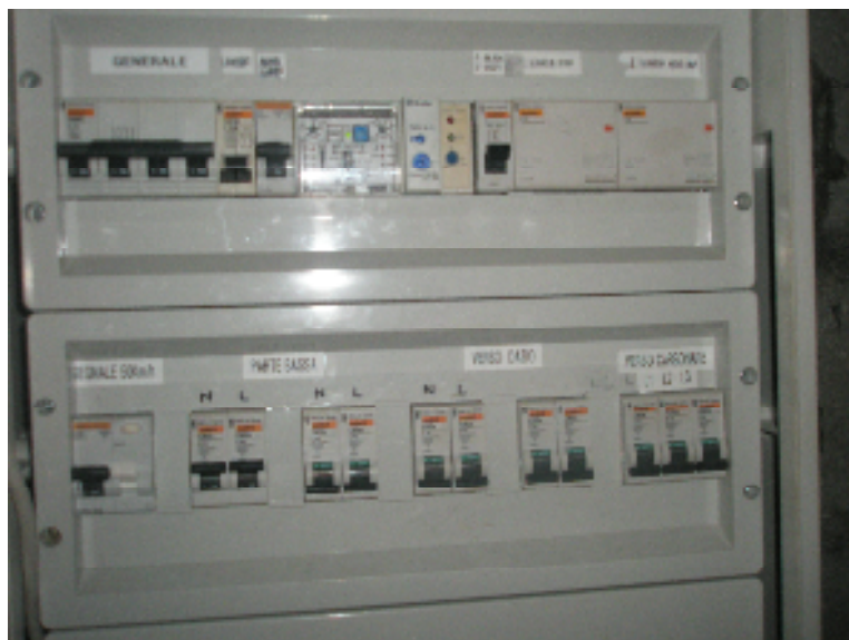
Fig. 44 Particolare quadro elettrico generale I.P. a Folgaria Nosellari (QNO1)
