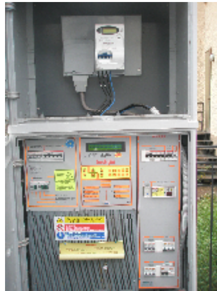
Fig. 46 Particolare quadro elettrico generale I.P. a Folgaria Carbonare (QCB1)
