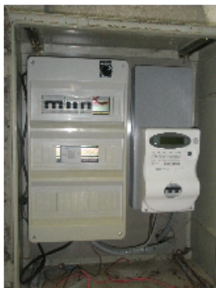
Fig. 35 Quadro elettrico generale I.P. a Folgaria Fondo Grande (QFG1)
