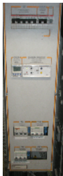
Fig. 72 Particolare quadro elettrico generale I.P. a Folgaria Palaghiaccio (QFL6)
