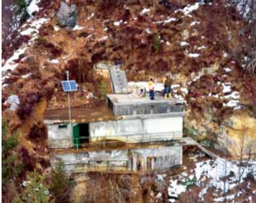
Tra gli impervi anfratti di val di Gola l'opera di presa della sorgente Chior in una foto dello scorso autunno.
