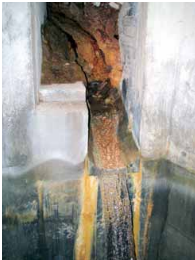
L'opera di presa della sorgente Chior (le foto di queste due pagine sono di Nicola Forrer, Ufficio Tecnico comunale).
