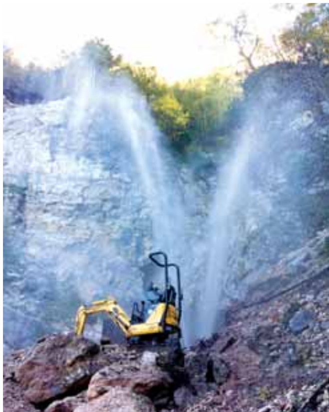
Quando il mini escavatore ha rimosso il materiale che copriva il guasto l'acqua ne è uscita con potenti getti.
